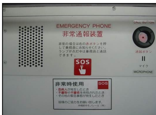
車椅子スペース部 非常通報装置
