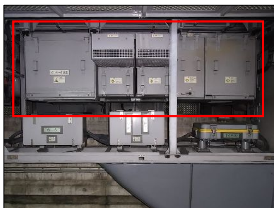
補助電源装置（SIV装置）
