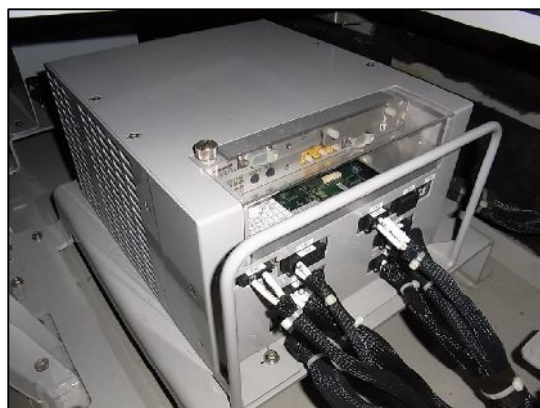
運転状況記録装置
