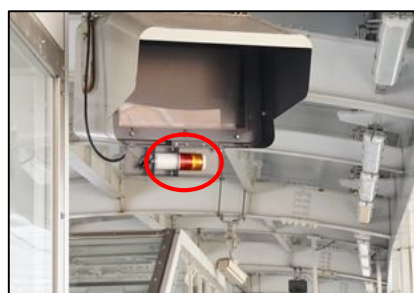
支障物センサーが動作すると赤色灯が点灯する
